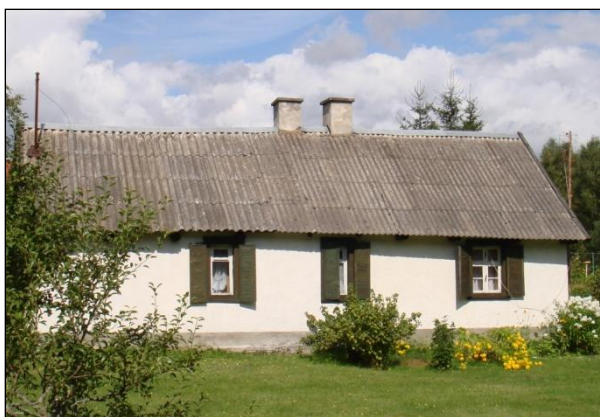
Fot. 1 Płyty azbestowo-cementowe faliste
